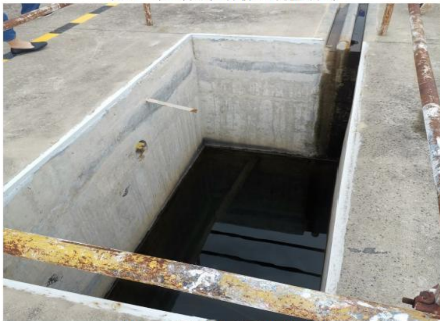
图 5 码头上设置污水收集池
